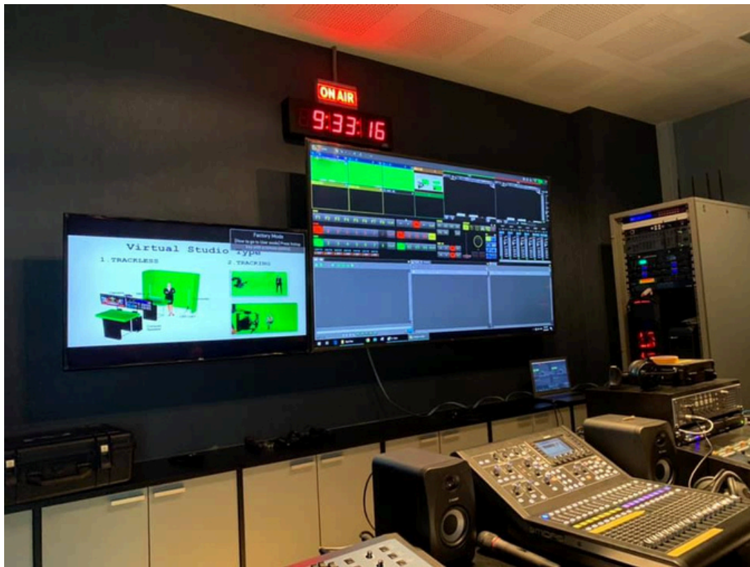
ห้อง Control
